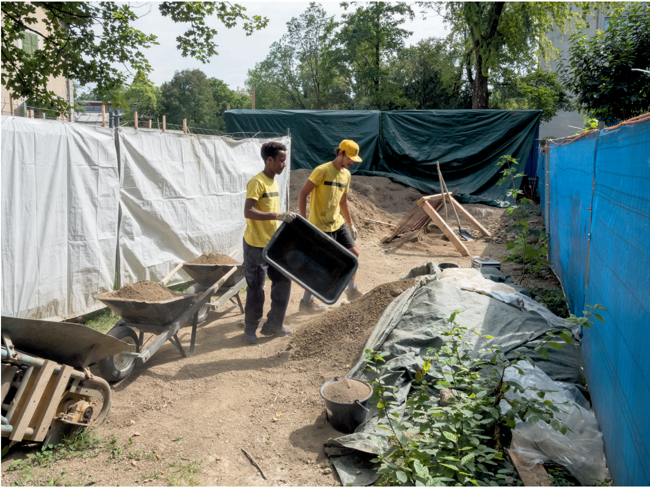
Rund 170 Kubikmeter Aushub wurden auf der Baustelle der Schulhauserweiterung im Geisendorf-Park in Genf für die Ziegelproduktion aufbereitet. Fotos Baustelle: Nicole Zermatten / Stadt Genf
